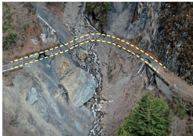
被災箇所の様子 上空から見たところ
