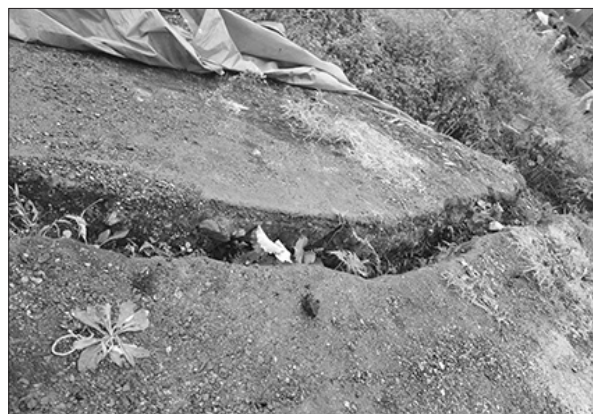
写真2 地割れができていた様子
