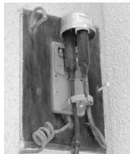
各戸の軒下に設置してあるCATVの保安器
