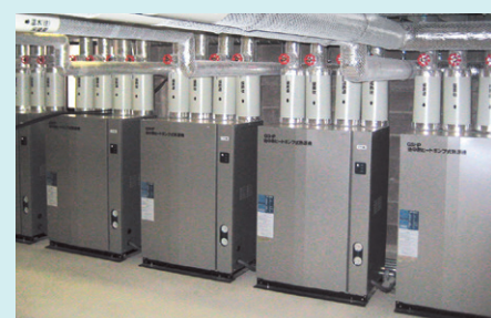
地中熱ヒートポンプ
