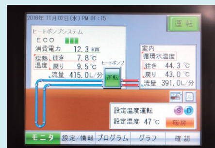
地中熱ヒートポンプ制御盤
