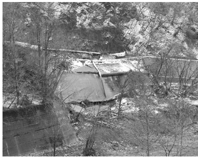
村道沢井線被災状況
